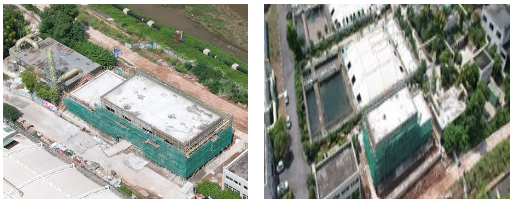
图1-2 取水泵房扰动现状
