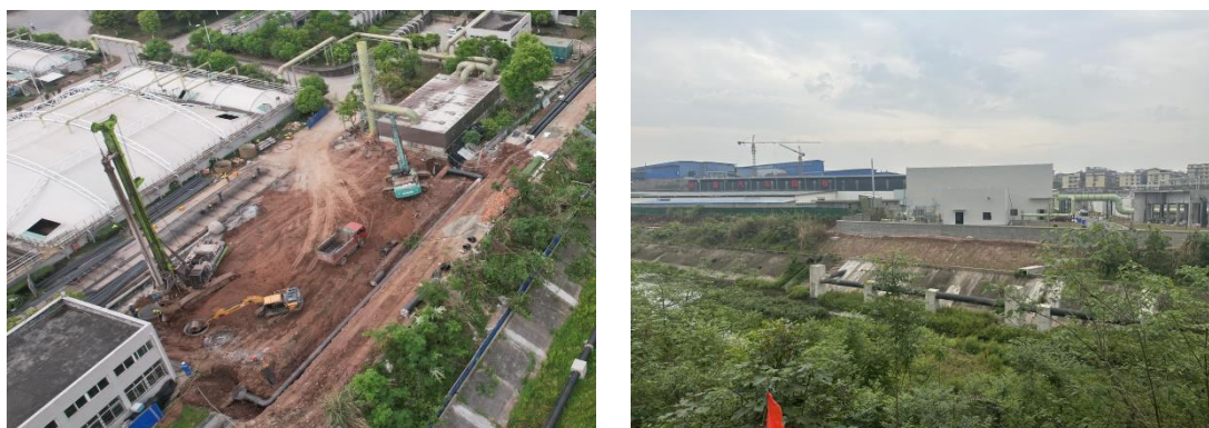
图1-3 取水泵房扰动现状
